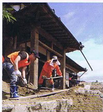
家屋を解体するには泥だしが必要
